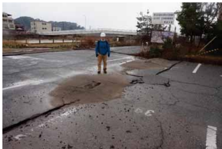
金沢港湾空港工事事務所（輪島事務所）駐車場での噴砂
