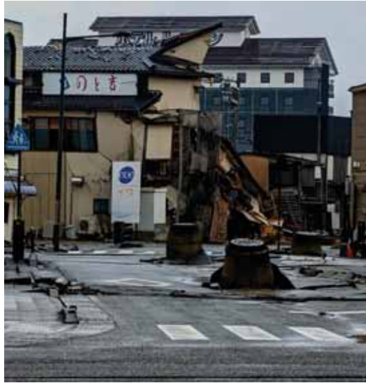
市街地におけるマンホールの浮き上がり
